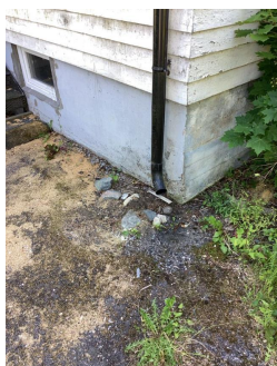
Manglende kontrollert bortledning av vann.
