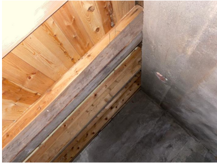
Manglende isolasjon i bjelkelag.
