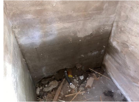
Synlig fukt på grunnmur i krypkjeller.
