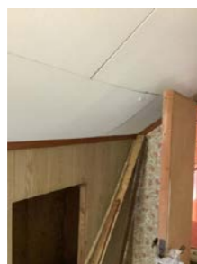
Observert skjevheter/løse plater. Ukjent årsak.
