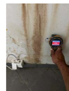
Indikasjoner på fuktgjennomtrenging på kjellervegg.
