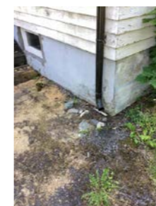
Manglende kontrollert bortledning av vann.
