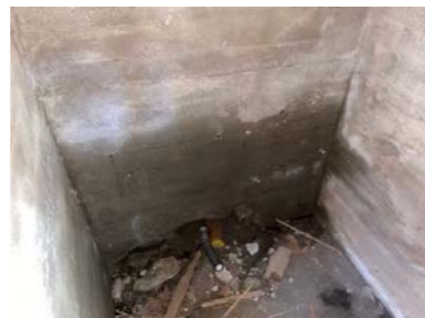
Synlig fukt på grunnmur i krypkjeller.
