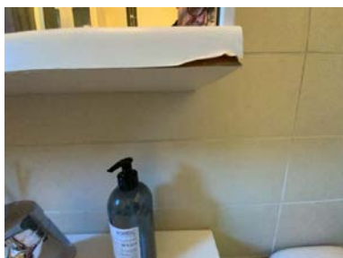
Skade på speilskap.
