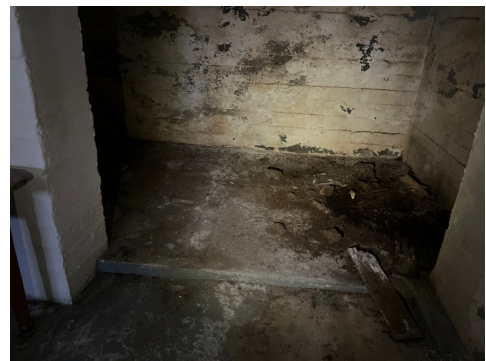
Fukt i kjeller grunnet bl.a. svikt i drenering/fuktsikring.
