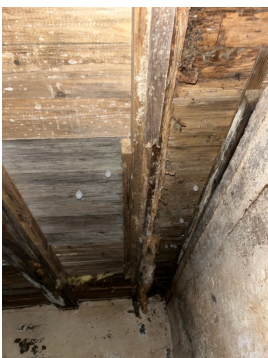
Fuktskadet bjelkelag med kokonger til edderkopp.
