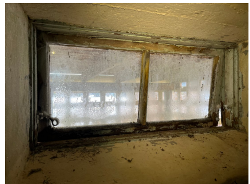
Kjellervinduer bør skiftes.
