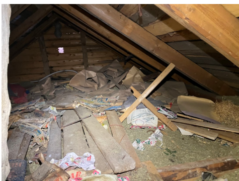
Møneloft bør ryddes og isolering skiftes ut.
