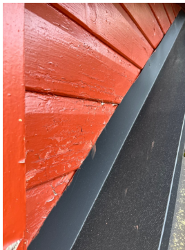
Beslag er feil montert på oppløft.
