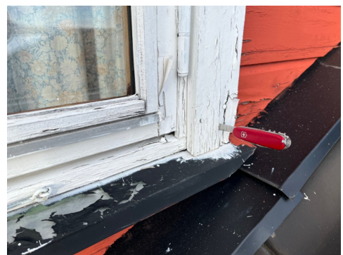
Råte i dekkbord og stor slitasje utvendige på vinduer.
