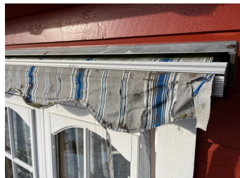
Markiser med skadet duk.
