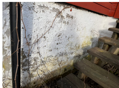
Løspuss på grunnmur.
