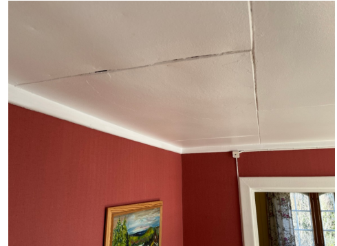
Fuktskadet himlingsplater på soverom.
