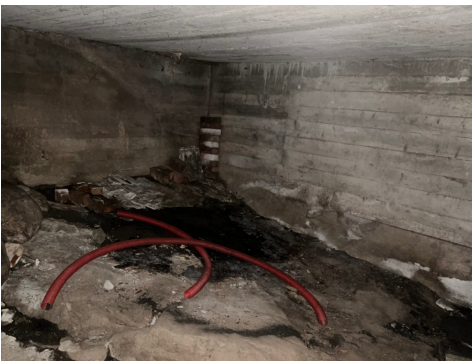
Fjell i dagen med innsig av vann fra terreng.
