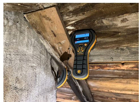
Fuktmåling ved gjennomføring av pipe på møneloft viste skadelig fukt.
