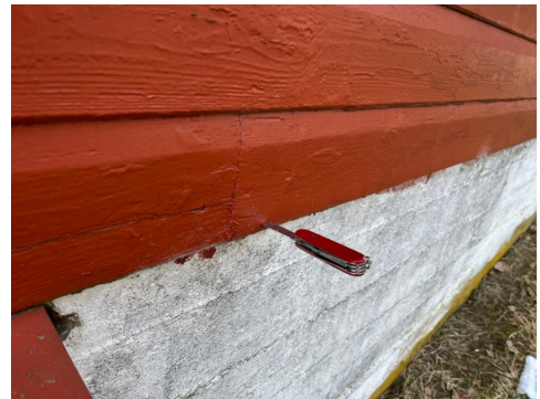
Råteskade i nedkant på kledning.
