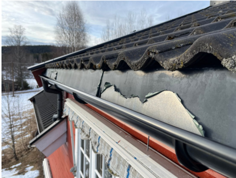
Beslag med avflasket lakk.
