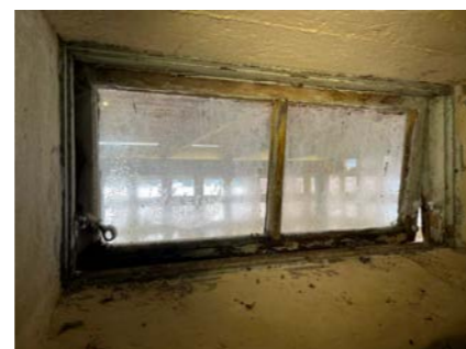
Kjellervinduer bør skiftes.
