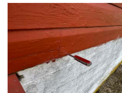
Råteskade i nedkant på kledning.
