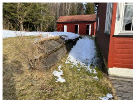
Terreng heller mot bygning.
