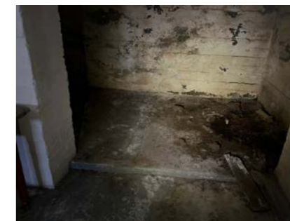
Fukt i kjeller grunnet bl.a. svikt i drenering/fuktsikring.
