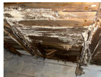
Bjelkelag under tilbygg har sopp og råteskader.
