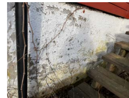
Løs puss på grunnmur.
