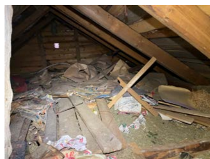
Møneloft bør ryddes og isolering skiftes ut.
