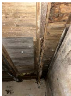
Fuktskadet bjelkelag med kokonger til edderkopp.
