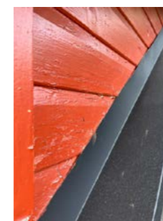
Beslag er feil montert på oppløft.
