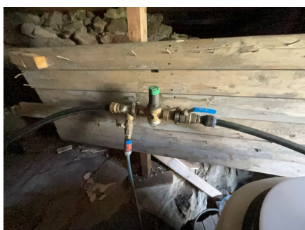
Stoppekran til vann.
