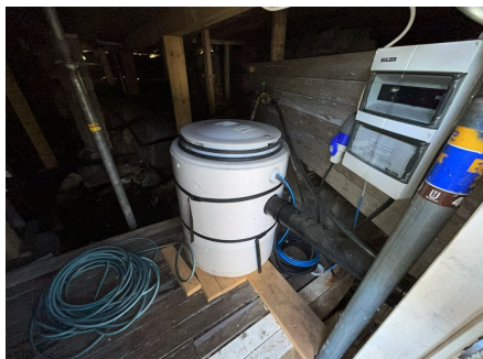
Tank med kværnepumpe.
