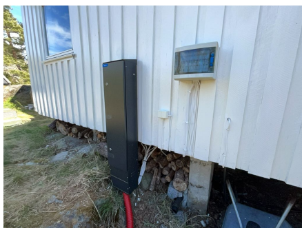
Utvendig skap med hovedsikringer og måler. Sikringsskap.
