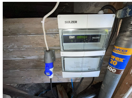
Styreskap til pumpekum.
