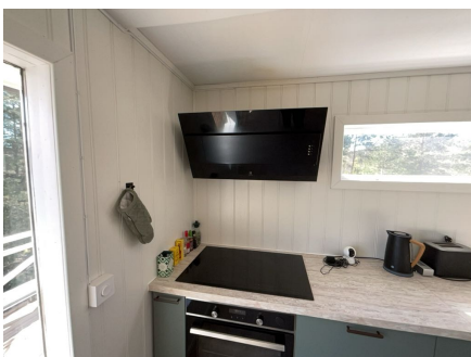
Montert avtrekk over steketopp.
