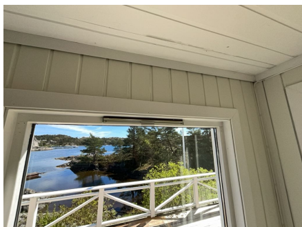
Eksempel på montert ventil i vindu.
