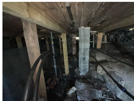
Det er avvik på understøttelser.
