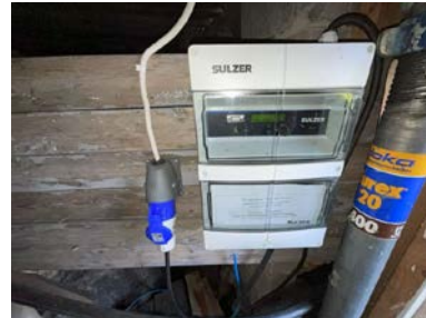
Styreskap til pumpekum.
