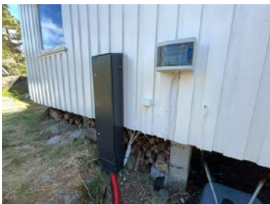
Utvendig skap med hovedsikringer og måler. Sikringsskap.
