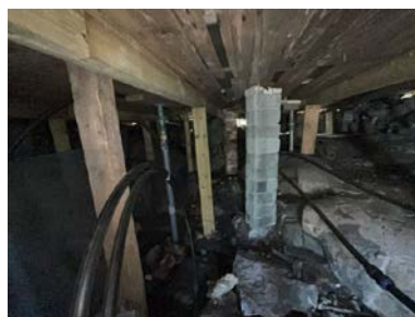
Det er avvik på understøttelser.
