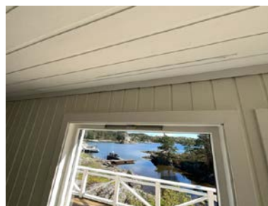
Eksempel på montert ventil i vindu.
