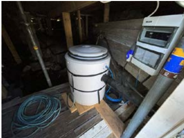
Tank med kværnepumpe.
