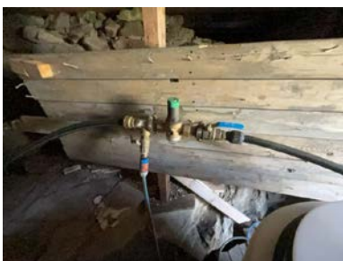
Stoppekran til vann.
