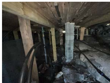
Det er avvik på understøttelser.
