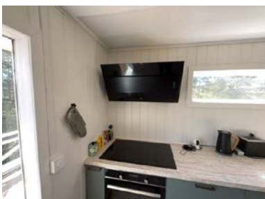
Montert avtrekk over steketopp.
