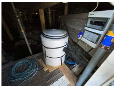
Tank med kværnepumpe.
