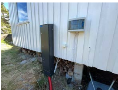
Utvendig skap med hovedsikringer og måler. Sikringsskap.
