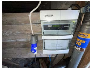
Styreskap til pumpekum.
