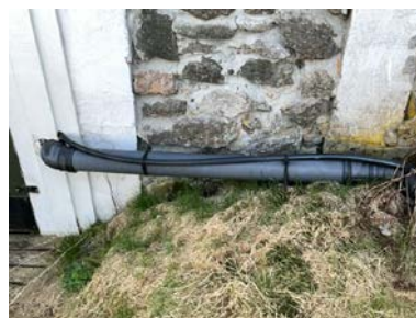
Del av rør til avløp.
