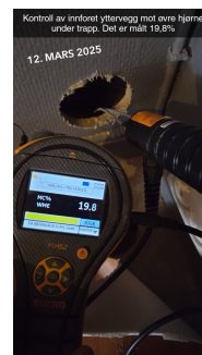
Kontroll av innforet yttervegg mot øvre hjørne under trapp. Det er målt 19,8%. Vegg er bygget opp med lettklinkerblokk, dampspærre, isolasjon o sponplate med malt stritetapet
