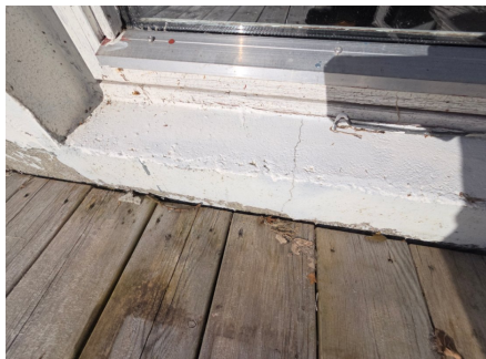
Riss/mindre sprekker ved vinduer i kjeller
