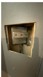
Hovedsikring er plassert ved kjellertrapp
