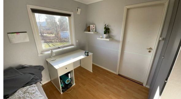
1. etasje Plassering av laser ved kontroll av soverom 3. Det er målt 7 mm høydeforskjell gjennom rommet. TG 1
