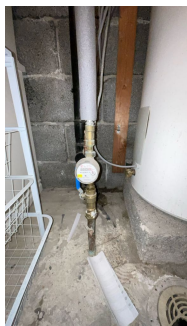
Hovedstoppekrane med vannmåler
