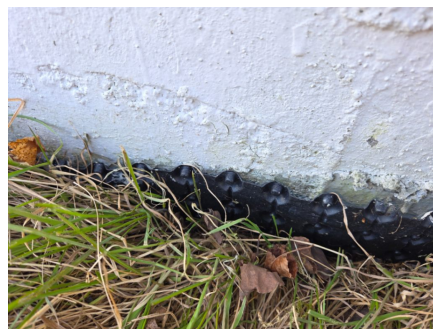
Mangler kantlist på grunnmursplast
