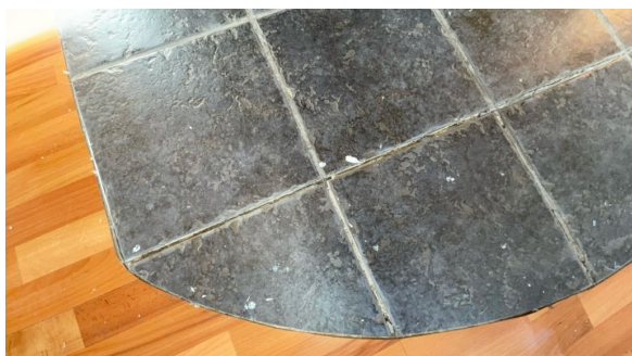
Riss/skade i flisfuger og bom i flis ved ildsted i kjeller
