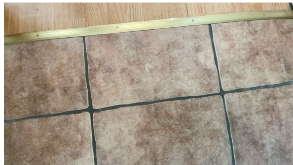
Riss/sprekker i flisfuger og bom (løse fliser) på deler av fliser på kjøkkengulv.
