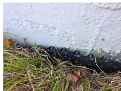
Mangler kantlist på grunnmursplast
