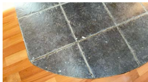
Riss/skade i flisfuger og bom i flis ved ildsted i kjeller
