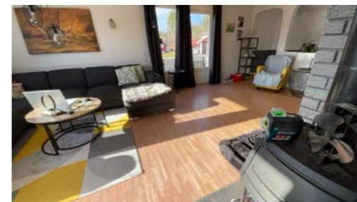
1. etasje Plassering av laser ved kontroll av stue. Det er målt 14 mm høydeforskjell gjennom rommet. TG 1
