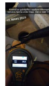
Kontroll av gulvbjelke oppforet tilfarergulv mot øvre hjørne under trapp. Det er målt 17%
