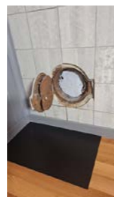
Selger har etter befaringen montert sotlukestein/plate og montert plate på gulv ved sotluke for å ivareta brannsikkerheten.
