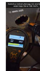
Kontroll av innforet yttervegg mot øvre hjørne under trapp. Det er målt 19,8%. Vegg er bygget opp med lettklinkerblokk, dampspærre, isolasjon og sponplate med malt stritetapet
