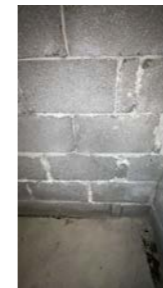
Saltutslag mot ytre hjørne i lagerrom
