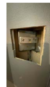
Hovedsikring er plassert ved kjellertrapp
