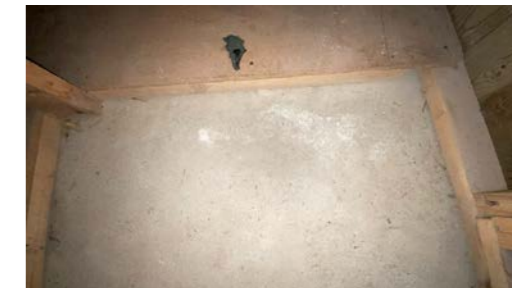
Saltutslag på gulv i bod
