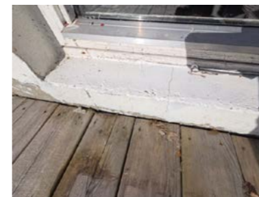
Riss/mindre sprekker ved vinduer i kjeller
