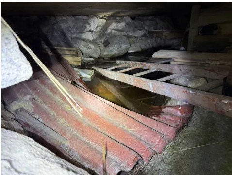
Større vannansamling på bakke under bolig. Eternit plater er lagret i krypkjeller.
