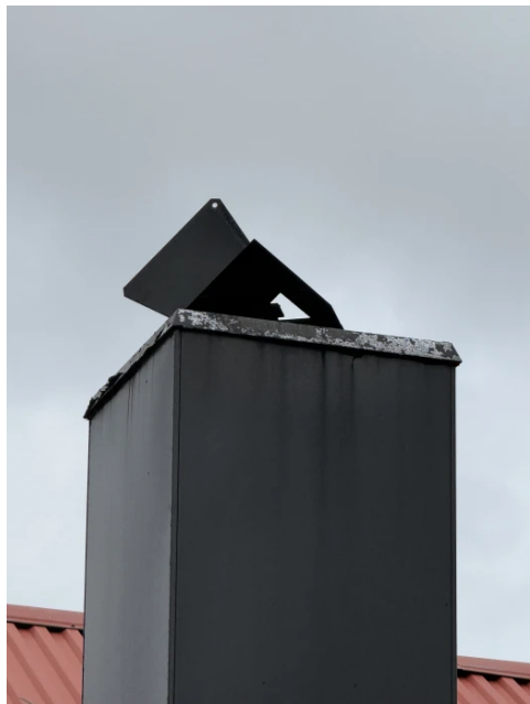
Beslag over pipe er løsnet.
