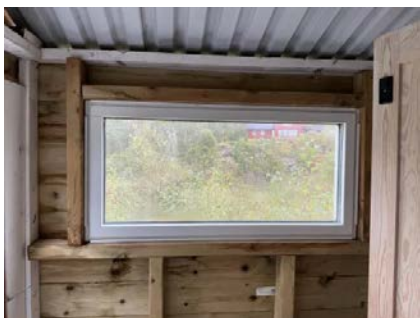
Bærende konstruksjoner på overbygg ved inngang er ikke fagmessig utført.
