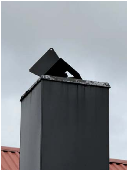
Beslag over pipe er løsnet.
