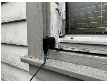
Fukt/råte på noen vindu.
