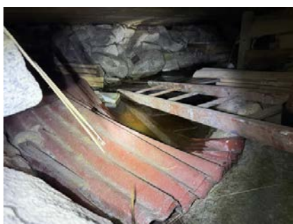
Større vannansamling på bakke under bolig. Eternit plater er lagret i krypkjeller.
