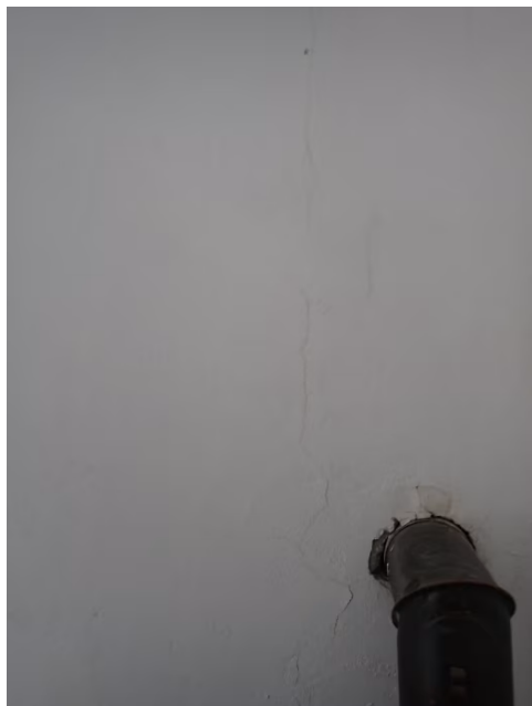
Krakelering/bom i puss
