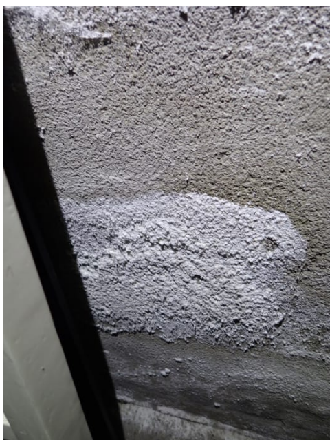
Saltutslag i grunnmur
