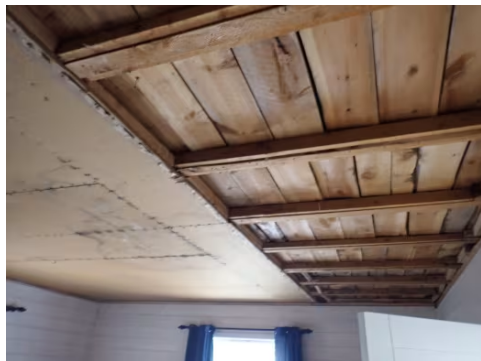
Skjolder i takplater
