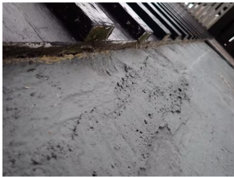
Dårlig/manglende lufting oppunder kledning
