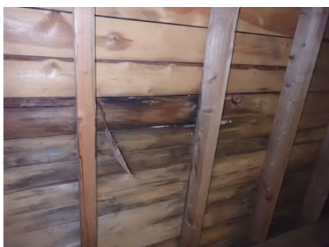
Sverting/sopp i taktro på loft
