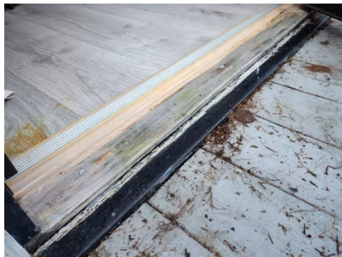
Fukt i dørterskel, balkongdør i 1. etasje
