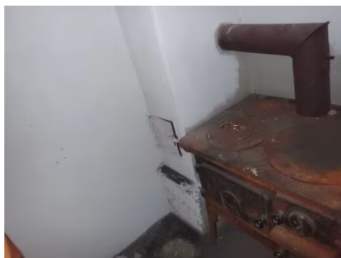
Rust i ovn
