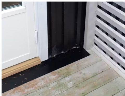
Skjult tettesjikt ved vegg/dør
