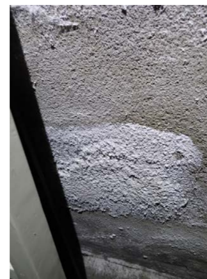
Saltutslag i grunnmur
