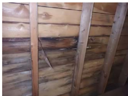
Sverting/sopp i taktro på loft
