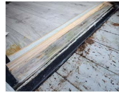
Fukt i dørterskel, balkongdør i 1. etasje
