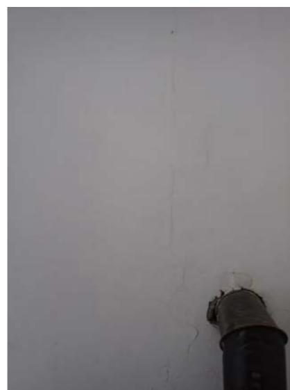
Krakelering/bom i puss
