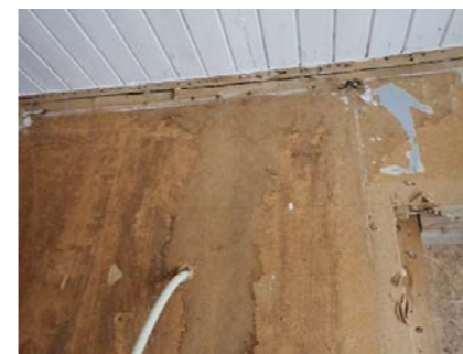
Skjolder ned på vegg
