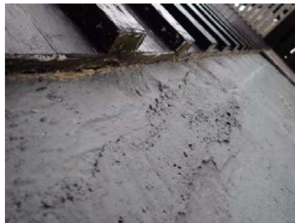
Dårlig/manglende lufting oppunder kledning
