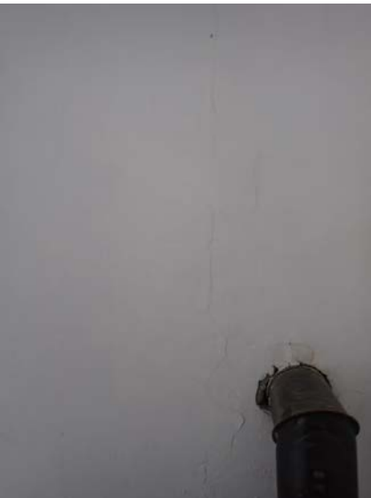
Krakelering/bom i puss
