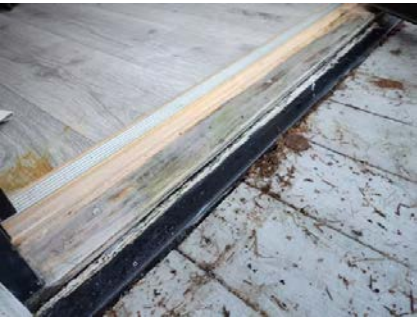
Fukt i dørterskel, balkongdør i 1. etasje
