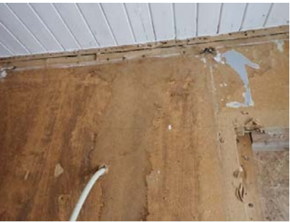
Skjolder ned på vegg
