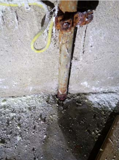
Skade i nedre del av rør
