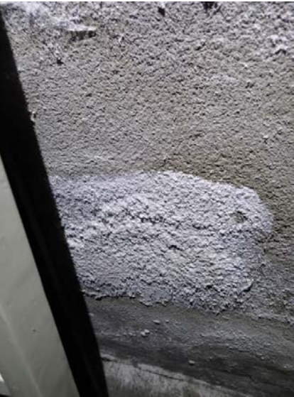
Saltutslag i grunnmur
