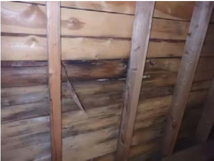
Sverting/sopp i taktro på loft
