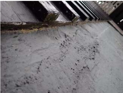
Dårlig/manglende lufting oppunder kledning
