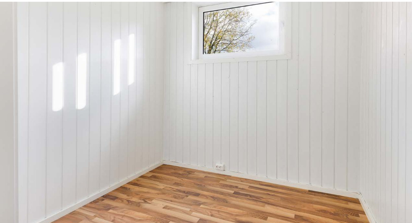
Kjeller: brukt som soverom (ikke godkjent) godkjent som hobbyrom/reskapsrom.
