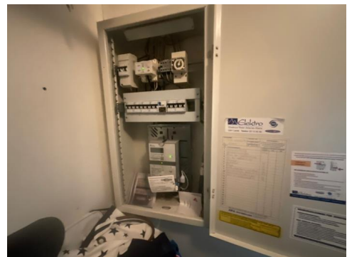
Sikringskap i boden
