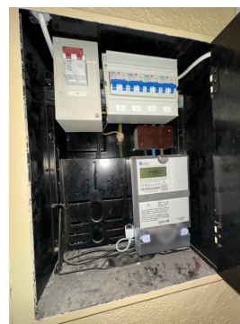
Sikringsskap med automatsikringer.
