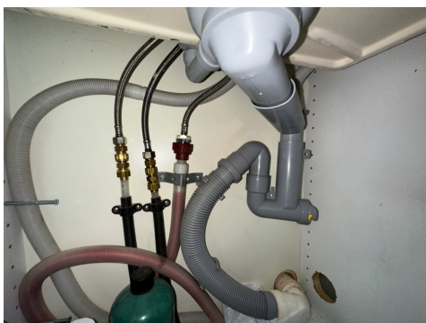
Røropplegg i kjøkkenbenk
