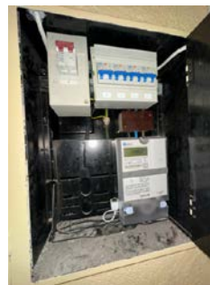
Sikringskap med automatsikringer.
