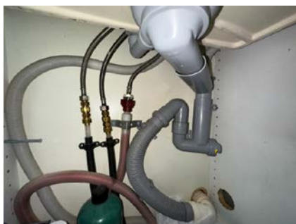
Røropplegg i kjøkkenbenk
