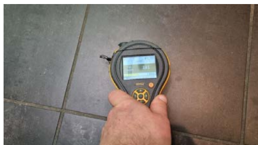
Det ble fuktmålt ved befaring, ingen unormale verdier ble registrert. Det bemerkes at fliser normalt har høyere fuktinnhold, normal fuktverdi i fliser ligger mellom 16-23%.
