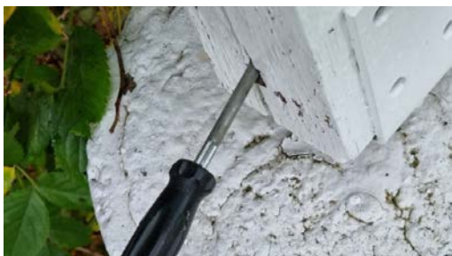
Det ble registrert råteskader i søyler.
