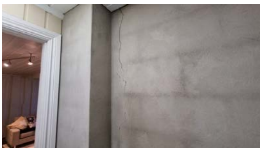
Sprekk i brannmur.
