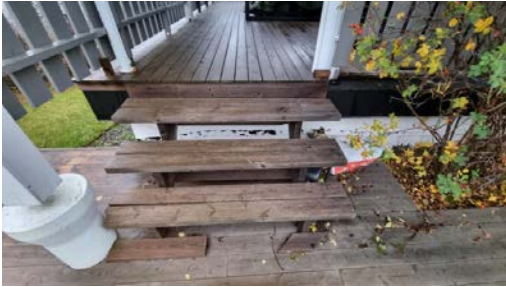
Trapp mangler rekkverk.
