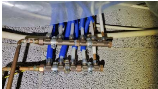
Det er vannledninger av plast (rør-i-rør) i deler av boligen.
