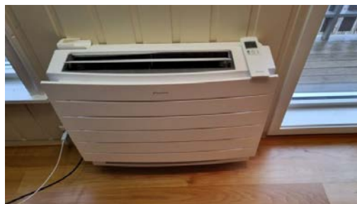
Varmepumpe fra 2023 i stuen i hovedetasjen.
