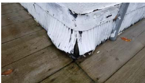
Utettheter/hull i grunnmursplast må tettes.
