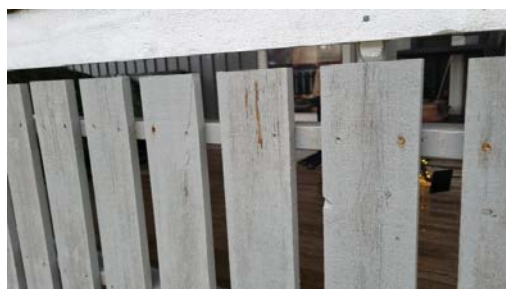
Rekkverket er værslitt.
