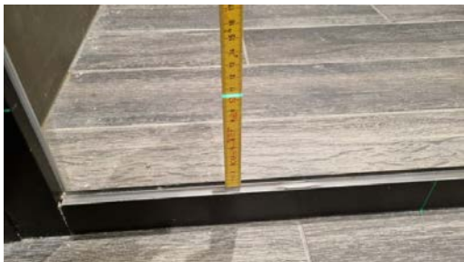
Det bemerkes at sluk på baderommet er delvis avsperrret med bunnlist for dusjvegg. Ved en eventuell vannlekkasje fra utsiden av dusjnisse, vil det samle seg en del vann på badegulvet før det renner til sluk.
