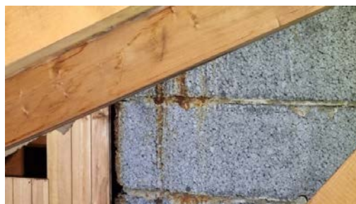
Pipa har rennemerker etter sotvann.
