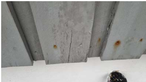
Det er værslitt/oppsprukket trevirke/trepaneler.
