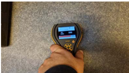
Det ble fuktmålt ved befaring, forhøyde fuktverdier ble registrert.
