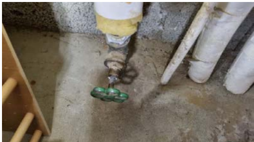
Hovedstoppekran av eldre dato uten kuleventil.
