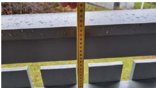
Rekkverket er for lavt i forhold til dagens krav til rekkverkshøyder.
