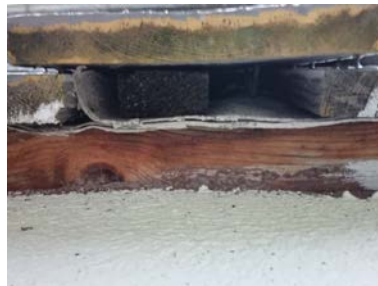
Det er ingen eller liten lufting i nedre kant av kledning mot grunnmur.
