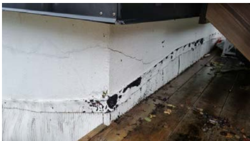
Sprekk/riss i grunnmur.
