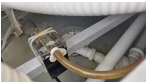
Det er begrenset mulighet for inspeksjon og rengjøring av sluk under badekar.
