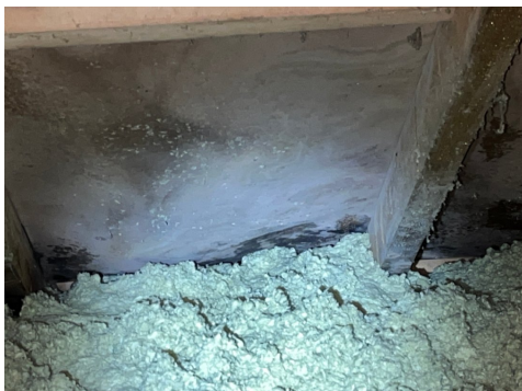
Soppvekst i undertak. Isolasjon ligger tett mot undertak
