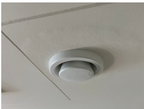
Svelleskade i himling ved ventil.
