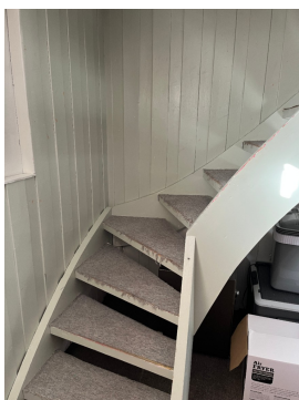
Manglende rekkverk, trapp til kjeller.
