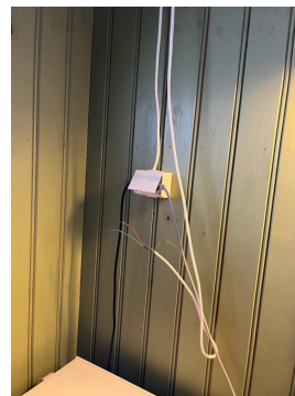
Løse ledninger vaskerom 1.etg.
