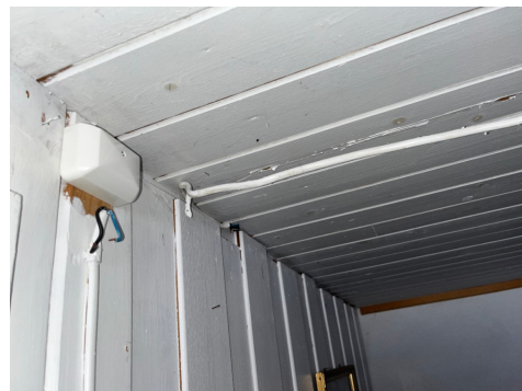
Løse ledninger i kjeller
