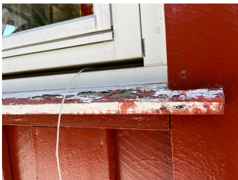
Manglende beslag under vinduer
