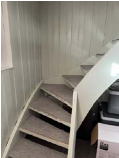
Manglende rekkverk, trapp til kjeller.
