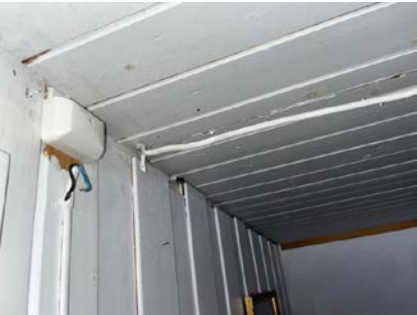
Løse ledninger i kjeller
