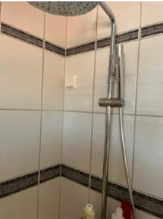
Stikkontakt i dusjsone, bad 1.etg.
