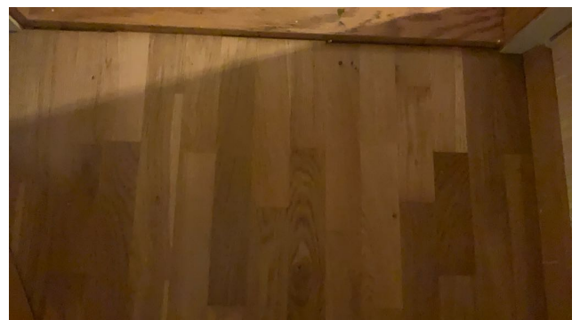
Knirk i parkett ved dør til soverom i kjeller.
