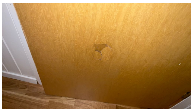
Skade i dørblad til soverom i kjeller.
