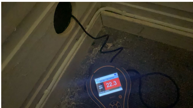
Hulltaking i kjellerstue. Her er det målt 22,3 vekt% samt plast på vegg.
