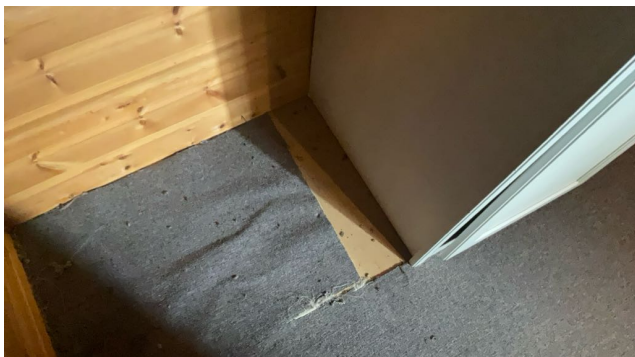
Gulv i soverom i kjeller, her mangler det noe teppe hvor garderobeskap har vært montert.
