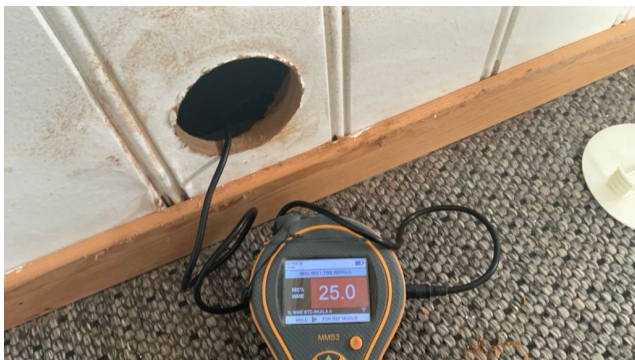
Soverom i kjeller. Her er det målt 25 vekt%, samt registrert følbart fukt mellom bunnsvill og grunnmur.
