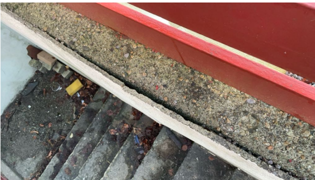
Puss på mur ved trapp til kjeller er løs i toppen.
