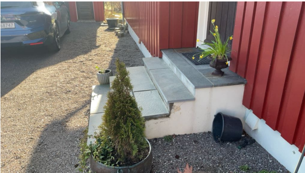
Trapp til inngangsparti er ikke sikret med rekkverk.
