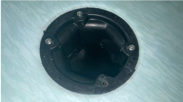
Plastsluk i gulv, hvor det mangler ei skrue i klemring
