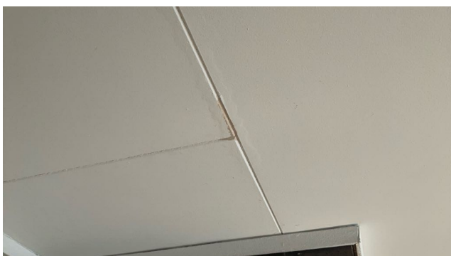
Fuktskade i skjøt av himlingsplater ved pipe i stue.
