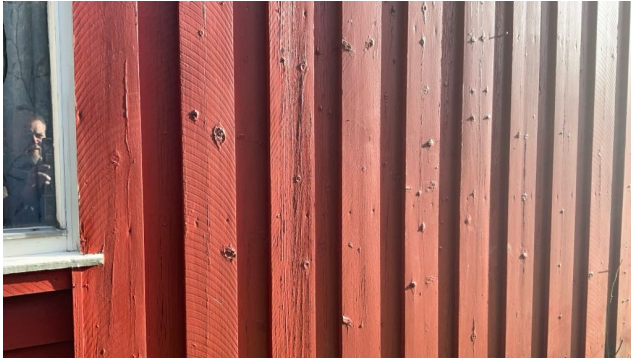
Tegn til noe vær og aldringsslitasje i kledning.
