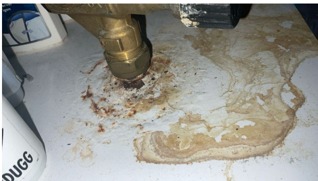
Rust og merke etter lekkasje fra blandeventil.
