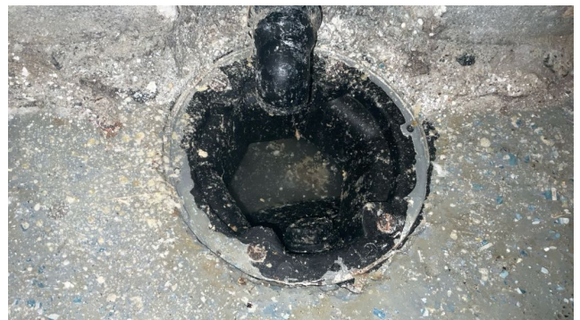
Pastsluk i gulv, uten tilsluttet tettesjikt/membran.
