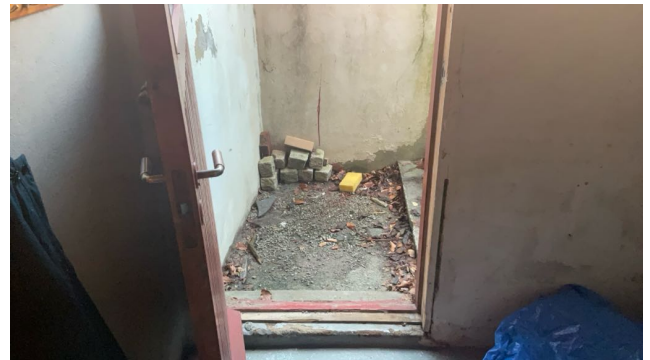
Innadslående kjellerdør, uten pakning.
