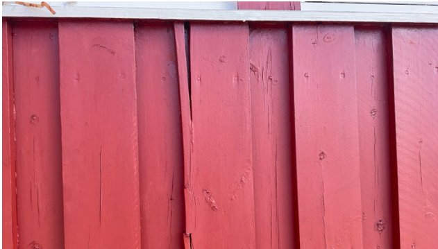
Sprukket kledningsbord på vegg ved terrasse.
