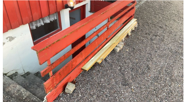
Rekkverk rundt kjellertrapp er for lavt samt åpninger er for store iht. krav i dagens forskrifter.
