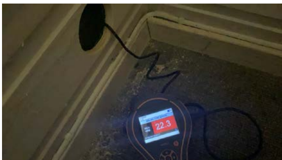
Hulltaking i kjellerstue. Her er det målt 22,3 vekt% samt plast på vegg.
