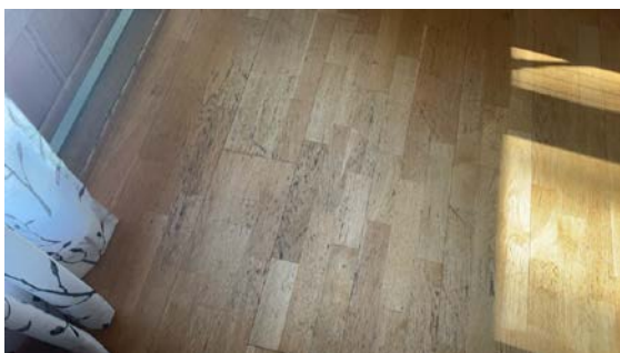
Parkett i stue er noe slitt i overflater.
