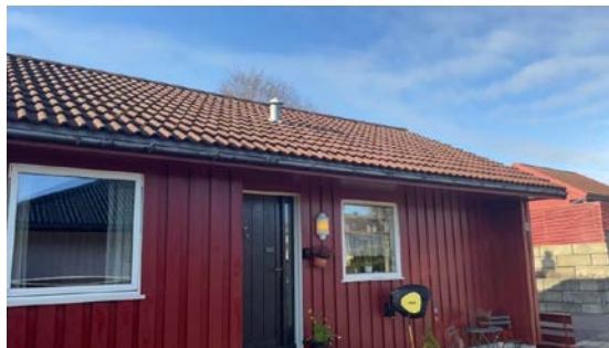
Det er ikke montert snøfangere på tak over inngangsparti.
