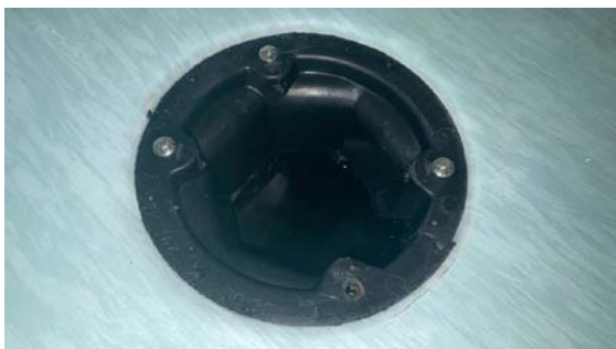
Plastsluk i gulv, hvor det mangler ei skrue i klemring
