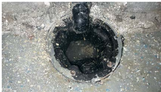
Pastsluk i gulv, uten tilsluttet tettesjikt/membran.
