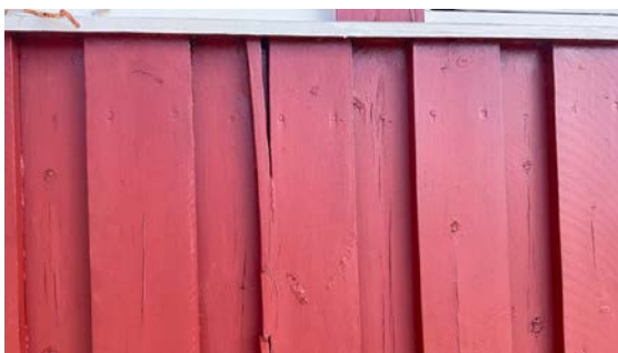
Sprukket kledningsbord på vegg ved terrasse.
