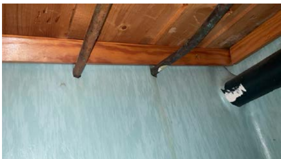
Utette gjennomføringer for vannrør i våtsone for dusj.
