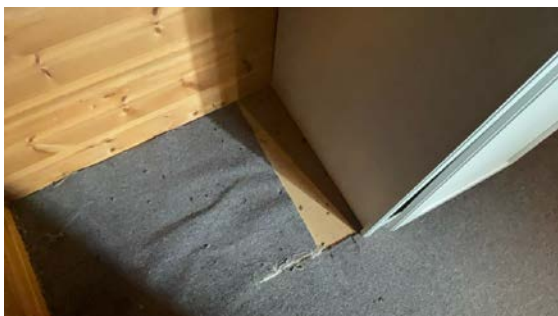
Gulv i soverom i kjeller, her mangler det noe teppe hvor garderobeskap har vært montert.
