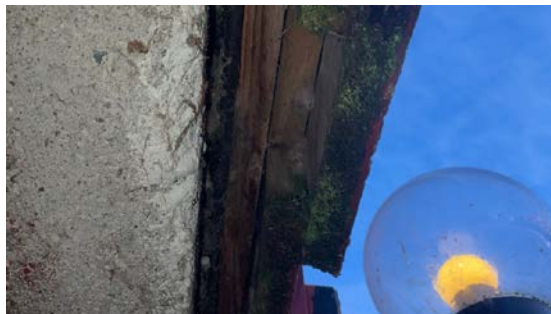
Det er ikke etablert åpning/luftespalte i nedre kant av kledning.
