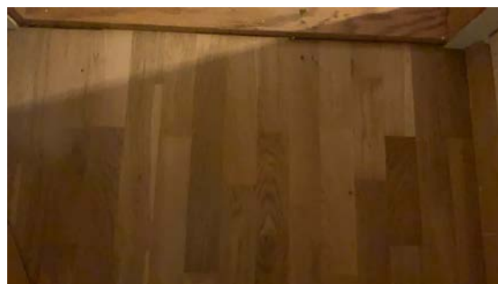
Knirk i parkett ved dør til soverom i kjeller.
