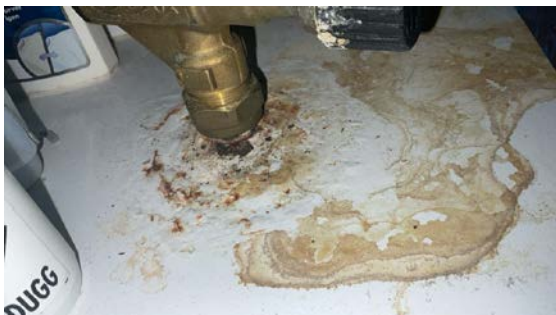
Rust og merker etter lekkasje fra blandeventil.
