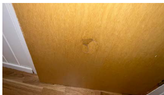
Skade i dørblad til soverom i kjeller.
