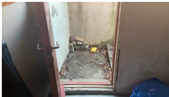
Innadsstående kjellerdør, uten pakning.
