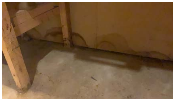
Fuktmerker i veggplater i nedre del av vegg i bod/verksted.
