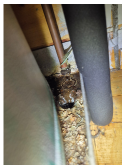
Lekkasjen fra ekspansjonsventil føres i avløp.
