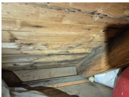
Ingen lufting ved raft.
