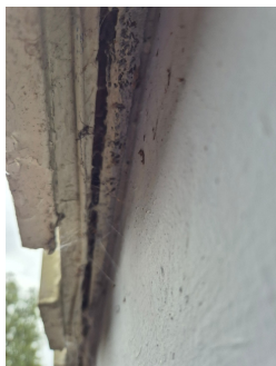
Mangler luftespalte i nedre del.
