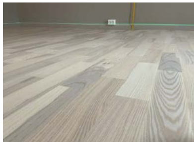
Helningsavvik på 22 mm ble målt i stue
