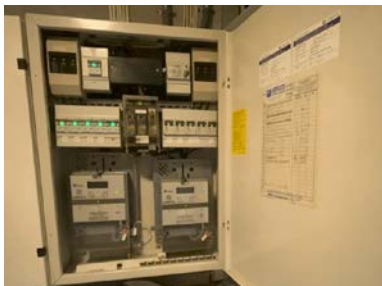
El-skap med automatsikringer, montert i felles teknisk rom for sameiet.
