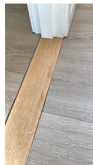
Ingen glippe mellom gulv og terskel.
