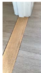
Ingen glippe mellom gulv og terskel.
