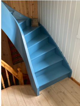
Trapp til loft, mangler rekkverk, lav gangbane
