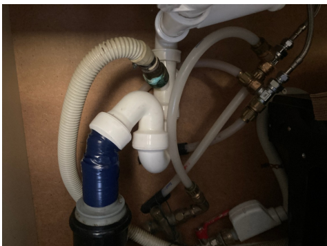
Mangler endemuffe rør i rør, avløp er teipa og irr på kobling
