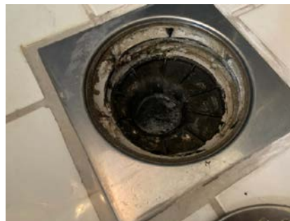
Sluk i dusjsone
