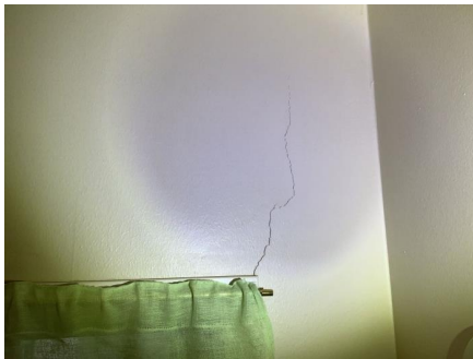
Sprekke over vindu på kjøkken.
