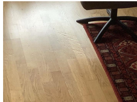
Skader i parkett i stue.
