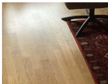
Skader i parkett i stue.
