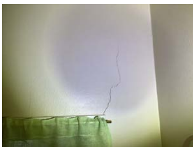
Sprekk over vindu på kjøkken.
