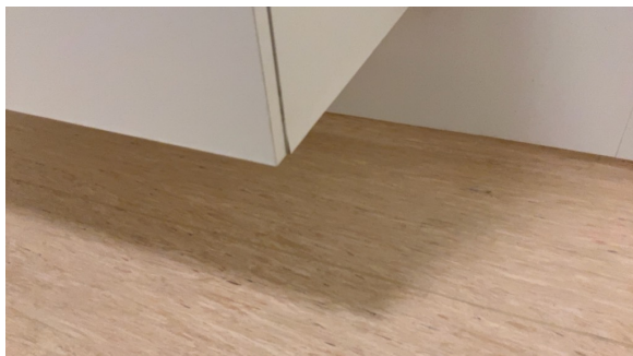
Begynnende svelling på siden av servanttinnredning.
