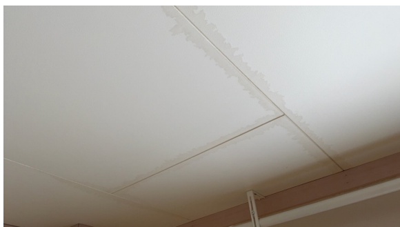
Fuktskjolder i himling på hovedsoverom.
