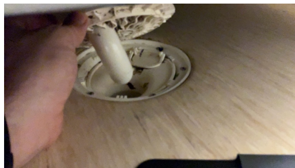
Sluk av plast med klemring.
