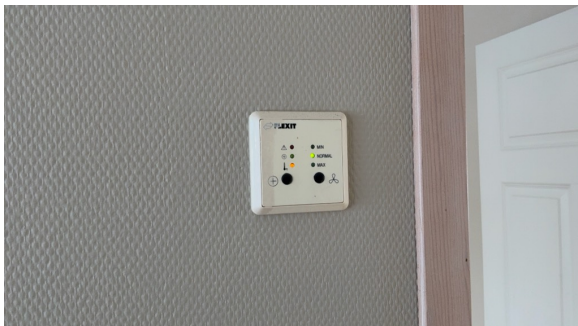
Styringspanel på kjøkken.
