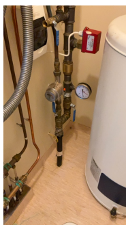
Vanninntak med måler og stoppekran.
