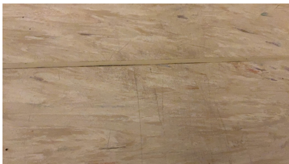
Det begynner å sprekke i sveiseskjøt på gulv.
