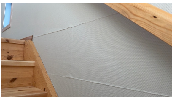
Synlige skjøter på tapet ved trapp
