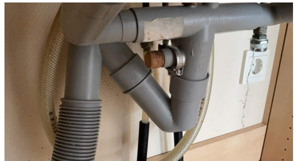
Forgrening på avløpsrør tettet med kork.
