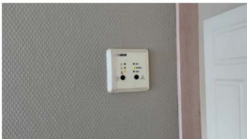
Styringspanel på kjøkken.
