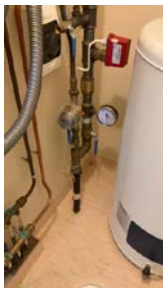
Vanninntak med måler og stoppekran.
