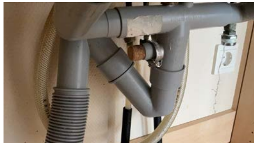
Forgrening på avløpsrør tettet med kork.
