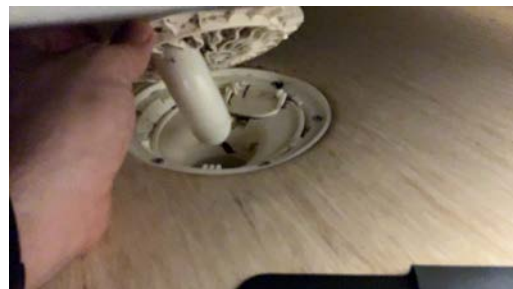
Sluk av plast med klemring.
