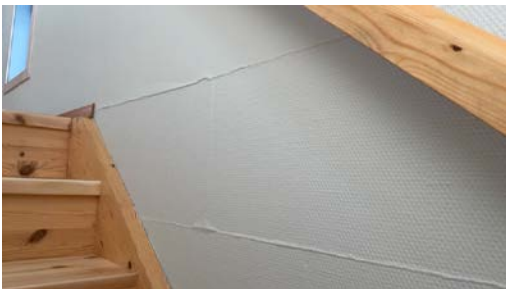
Synlige skjøter på tapet ved trapp
