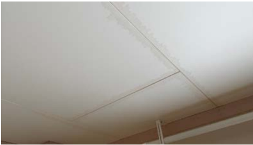
Fuktskjolder i himling på hovedsoverom.
