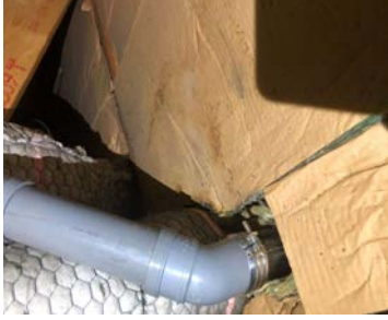
Fuktskjolder på isolasjon. Antatt fra kondens
