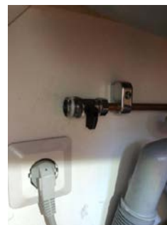
Bilde av vannuttaket til oppvaskmaskin
