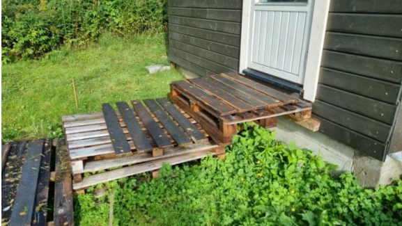
Provisorisk trapp uten rekkverk.
