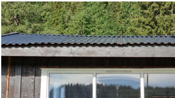
Det er ikke montert takrenner.
