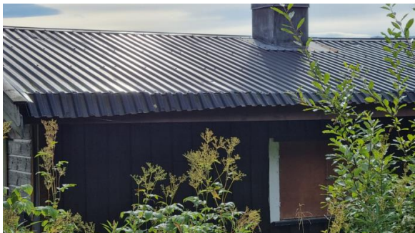
Taktekket har store nedbøyninger.
