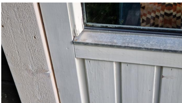
Terrassedør er værslitt.
