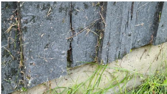
Stående tømmermannskledning er moden for utskifting.
