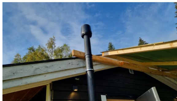
Lufting fra forbrenningstolett.
