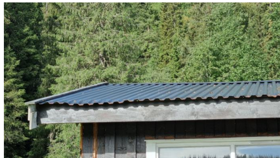
Taktekket har noe overflaterust.
