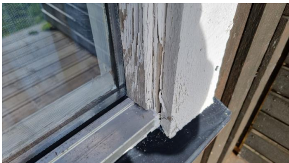
Vinduer har værslitasje.
