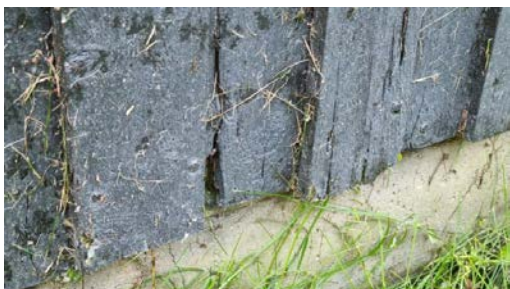
Stående tømmermannskledning er moden for utskifting.
