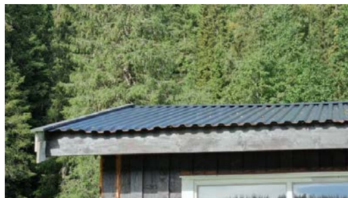
Taktekket har noe overflaterust.
