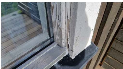
Vinduer har værslitasje.
