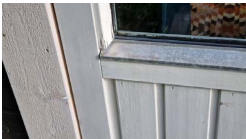
Terrassedør er værslitt.
