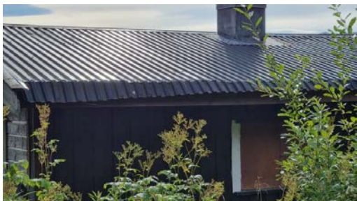
Taktekket har store nedbøyninger.
