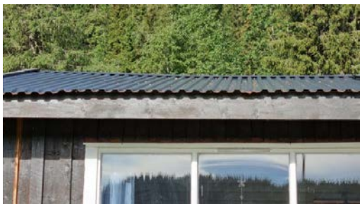
Det er ikke montert takrenner.
