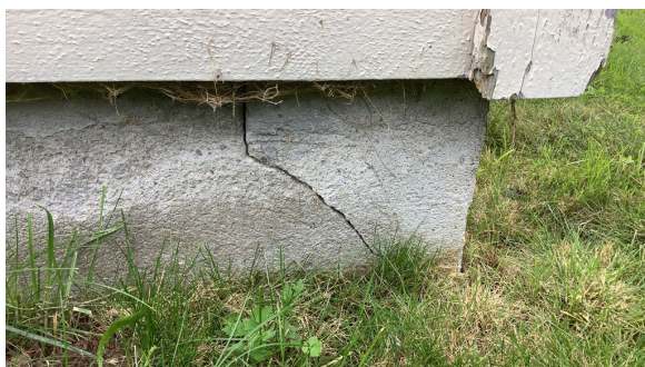
Sprekk i ringmur.
