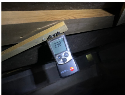
Det måles skadelig fuktinnhold i treverk.
