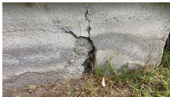
Sprekk i ringmur.
