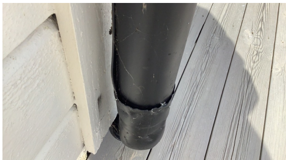
Eksempel på frostsprengt nedløpsrør.
