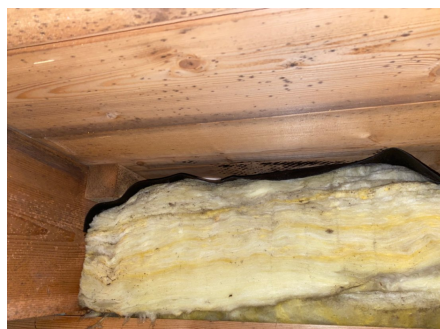
Luftespalte er stedvis sperret av isolasjon.
