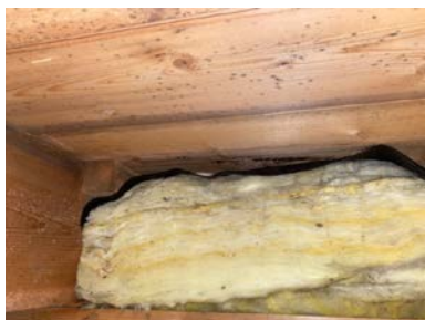
Luftespalte er stedvis sperret av isolasjon.
