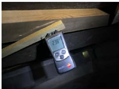
Det måles skadelig fukttinnhold i treverk.
