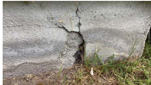
Sprekk i ringmur.
