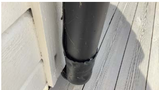
Eksempel på frostsprengt nedløpsrør.
