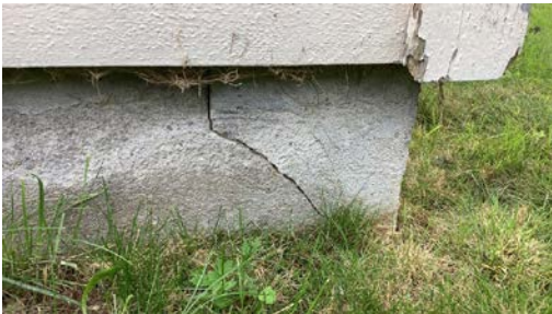
Sprekk i ringmur.
