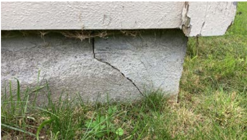
Sprekk i ringmur.
