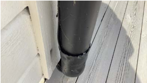
Eksempel på frostsprengt nedløpsrør.
