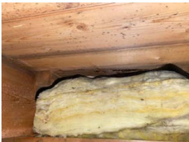
Luftespalte er stedvis sperret av isolasjon.
