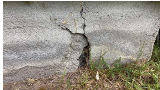
Sprekk i ringmur.
