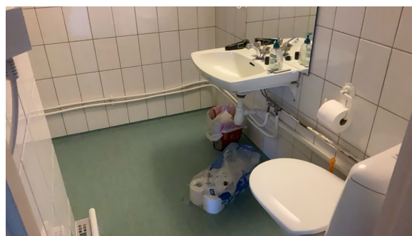
Deler av røropplegget bærer preg av ufagmessig utførelse.
