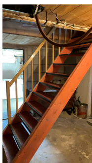
Trapp til kjeller mangler rekkverk på ene siden.
