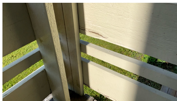
Det er registrert råteskader i rekkverk.
