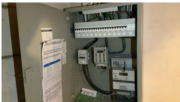
Sikringsskap med automatsikringer plassert i kjelleren.
