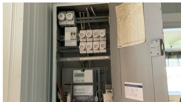
Sikringsskap med skru- og automatsikringer plassert i gang i loftetasjen.
