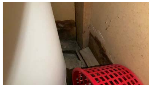
Overflater med fuktmerker i vaskekjeller anbefales å fjerne.
