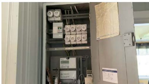
Sikringsskap med skru- og automatsikringer plassert i gang i loftetstjen.
