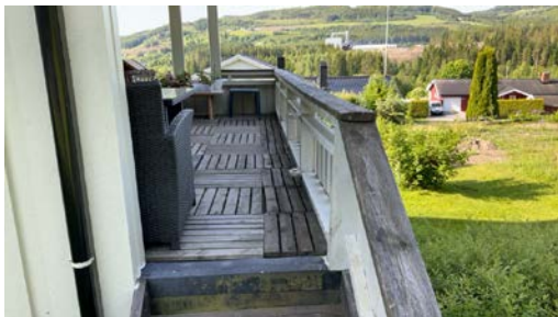
Dagens krav til høyde på rekkverk er 100 cm, rekkverk er lavere.
