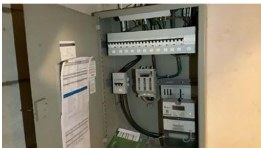
Sikringsskap med automatsikringer plassert i kjelleren.
