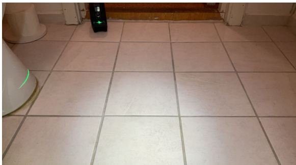
Lokalt motfall ved toalett.
