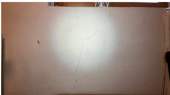
Det er registrert skråriss som er symptom på setninger.
