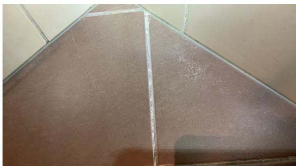
Sprekker i fuger i dusjsone
