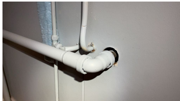
utettheter rundt rørføringer.
