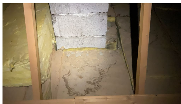
Gamle fuktmerket på isolasjon.
