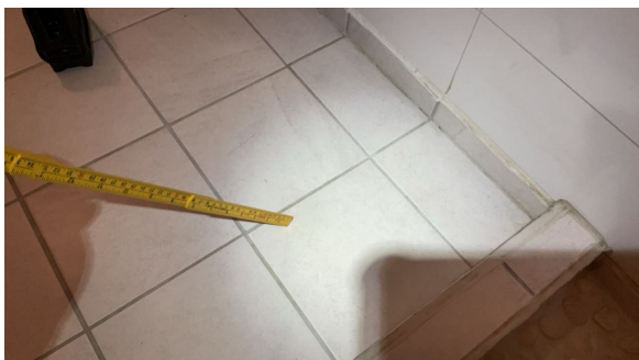
Bom/hullyd på flere fliser registrert.
