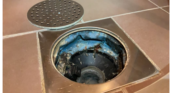
Feil utførelse på mansjett rundt klemring i sluk
