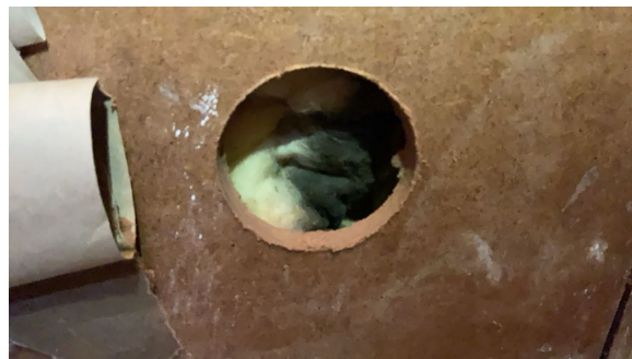
Misfarging på isolasjon.
