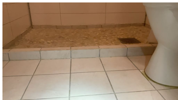
Det er ikke spalte i terskel mot sluk, slik at evt. lekkasjevann vil renne ut av våtrommet i stedet for ned i sluk.
