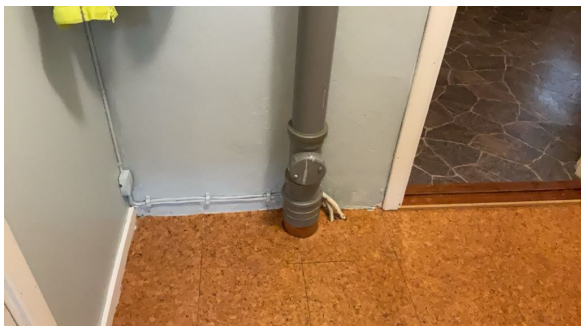
Stakeluke plassert i gang ved bad i kjeller.
