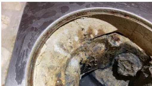
Rust på skruer registrert i sluk.
