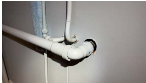
utettheter rundt rørføringer.
