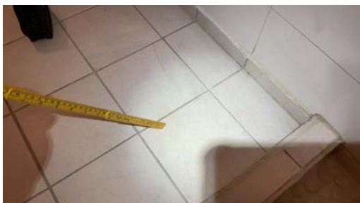
Bom/hullyd på flere fliser registrert.
