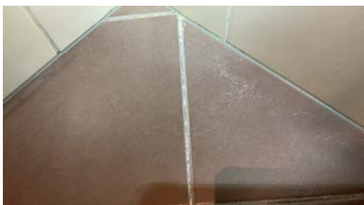
Sprekker i fuger i dusjsone
