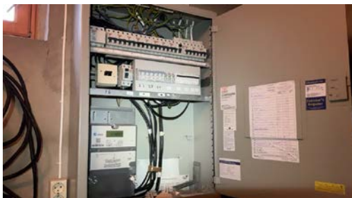
Sikringskap plassert i kjeller.
