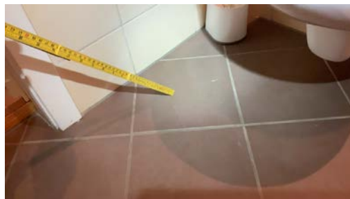
Bom/hulldyd på flis registrert ved dør.
