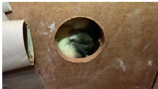
Misfarging på isolasjon.
