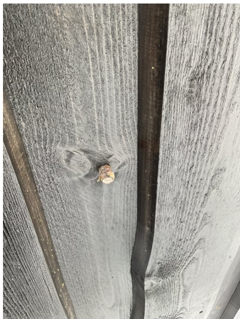
Kvistutslag i panel.
