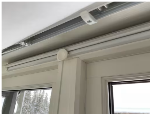
Ventiler i vindu.
