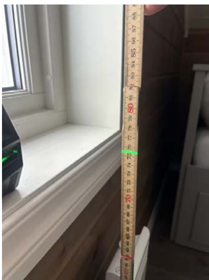
Skjevhet i soverom og stue.
