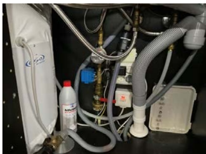
Stoppekran i kjøkkenbenk.
