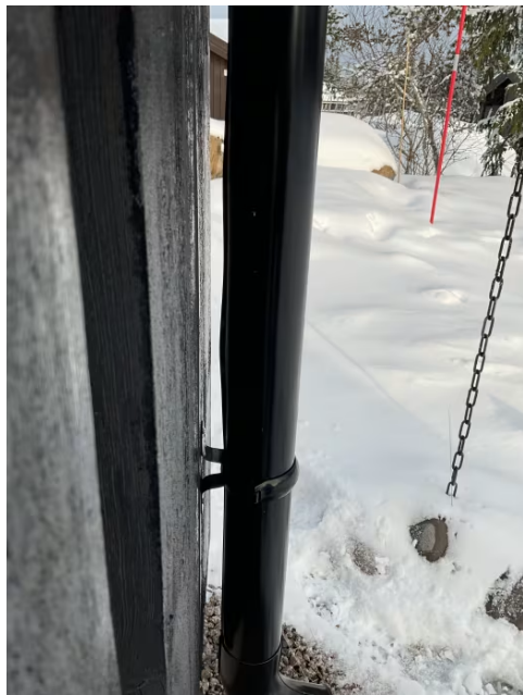
Frostspreng i nedløp.
