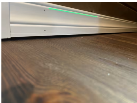
Sprekk mellom gulvlist og gulv.
