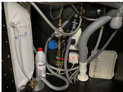
Stoppekran i kjøkkenbenk.
