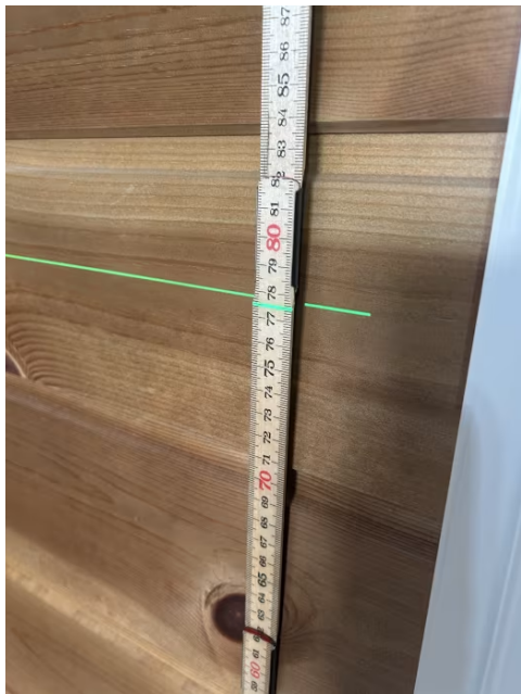
Skjevhet i soverom og stue.
