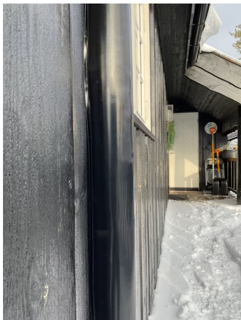
Frostspreng i nedløp.
