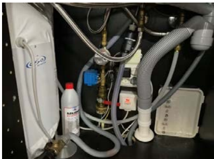
Stoppekran i kjøkkenbenk.
