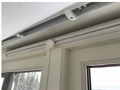
Ventiler i vindu.
