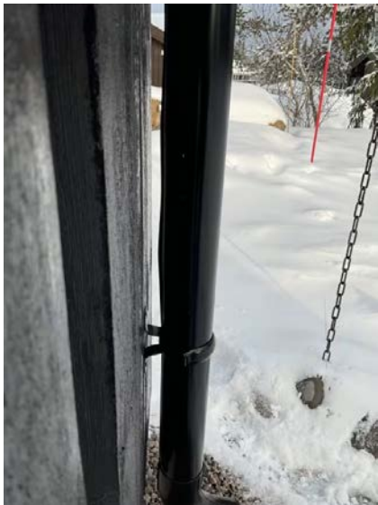
Frostsprenng i nedløp.
