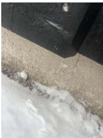
Sprekk i steinplate.
