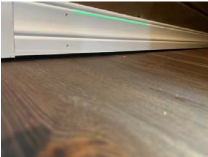
Sprekk mellom gulvlist og gulv.
