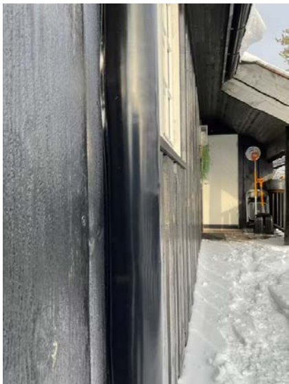
Frostsprenng i nedløp.
