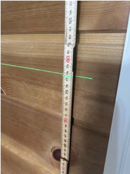
Skjevhet i soverom og stue.
