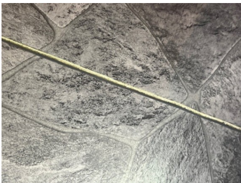
Sveis mangler i skjøt av gulvbelegg
